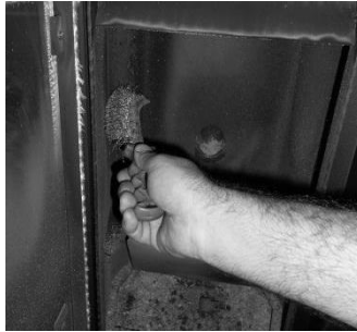
Figura 22 - Limpeza do interior da salamandra
