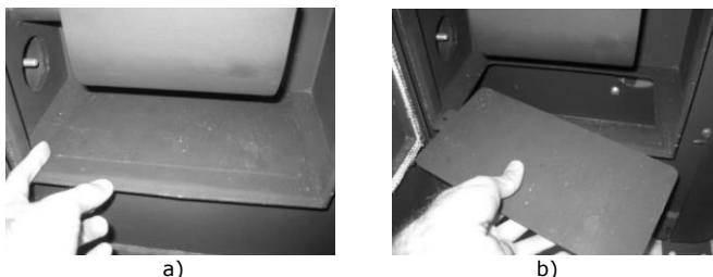
Figura 33 - Limpeza do interior da salamandra
