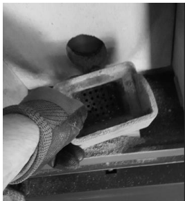
a) Remoção queimador
