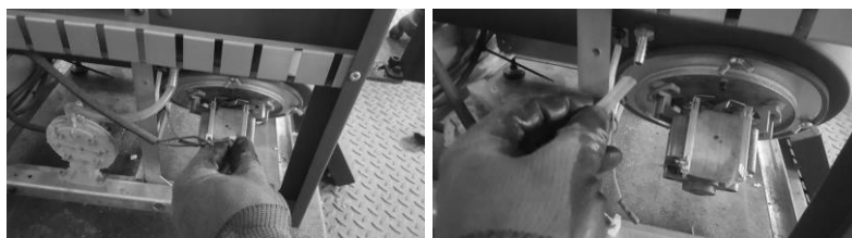
a) Cabos de ligação
